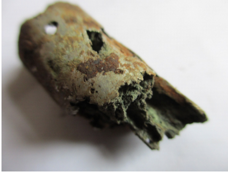
图11 不锈钢紧固件断口
