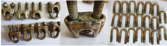
图 3 U型螺栓夹及组件腐蚀照片
